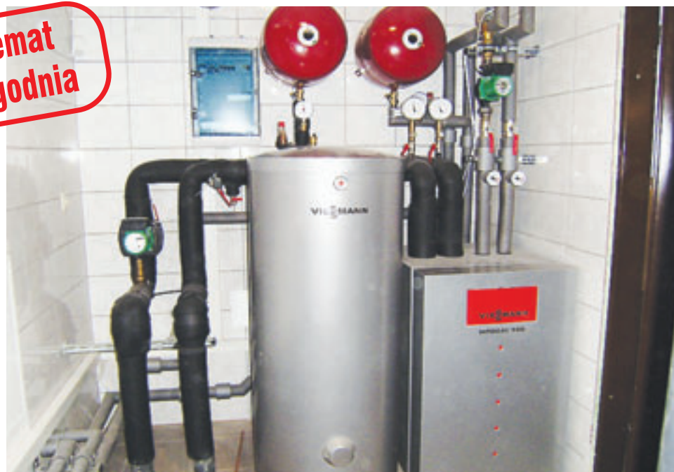
Instalacja z wykorzystaniem pompy ciepła nie wymaga stałego nadzoru ze strony użytkownika. Raz włączona i zaprogramowana, będzie działać, nie absorbując jego czasu Fot. Elektro-Sanit
