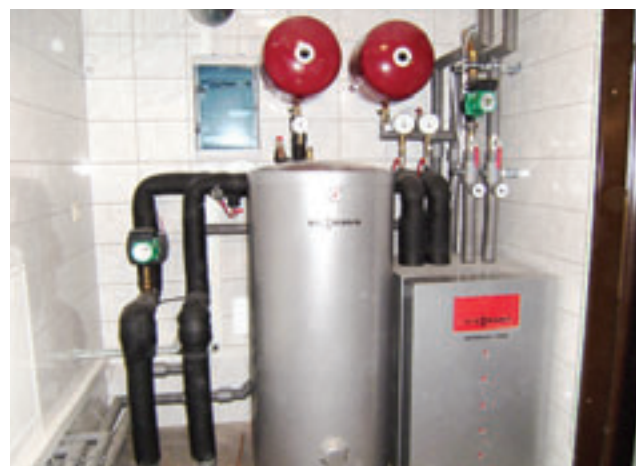
Przy zastosowaniu pomp ciepła 75 proc. energii do ogrzania budynku pozyskiwane jest z natury Fot. Elektro-Sanit
